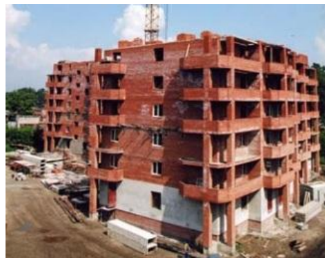
Объект незаконного строительства в районе ул. 1 Мая
